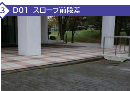
スロープの手前部分は段差が大きく、気付きづらいため、注意してください。
