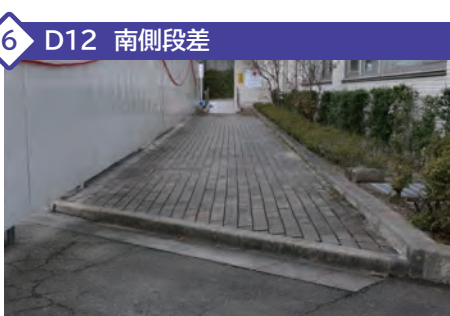
建物に接続する通路に気付きづらい段差があるため、注意してください。
