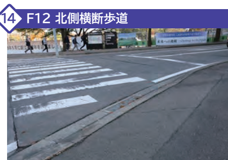
傾斜が急であることに加え、段差があるため転落・転倒に注意してください。
