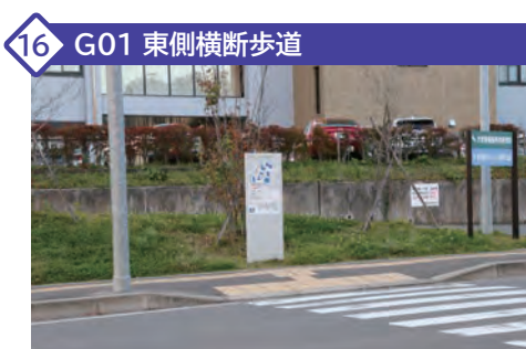
歩道と車道の境界に傾斜と段差があります。また、歩道の平坦な部分が狭いため、転倒に注意してください。
