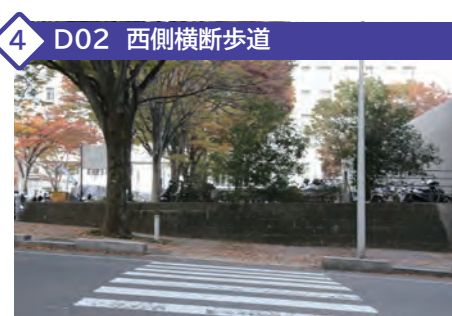
横断歩道が大きく横に傾いているため、転倒に注意してください。
